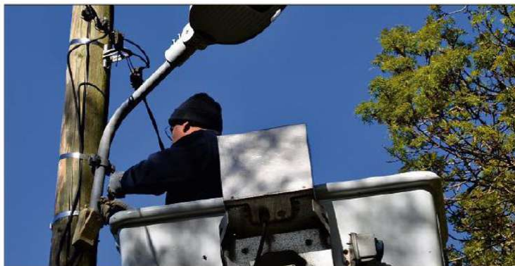
De nouveaux luminaires installés sur le chemin des Vignarets.
